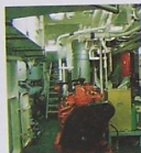
der Maschinenraum engine room 轮机舱
